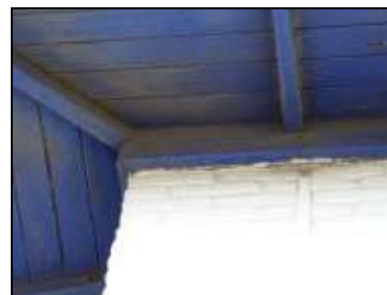
Figuur 47. Detail foto van de daklijst.
